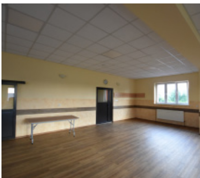
Sala na piętrze Domu Strażaka w Łące po gruntownym remoncie. Fot. P. Smotryś
